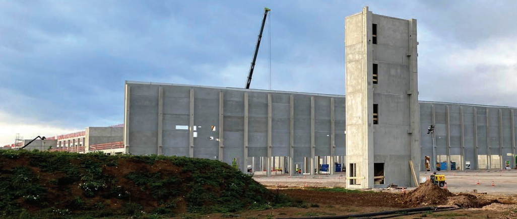
Der Bau der Batterie-Gigafactory des chinesischen Weltmarktführers CATL im Industriegebiet „Erfurter Kreuz“ in Arnstadt/Ichtershausen macht gute Fortschritte. Bild: LEG Thüringen
